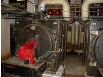
2 Kessel á 1.045 kW
