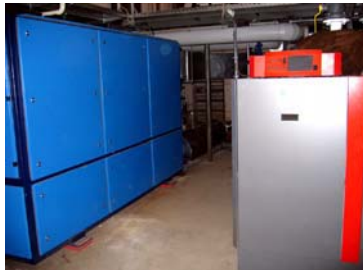
BHKW und Brennwertkessel
